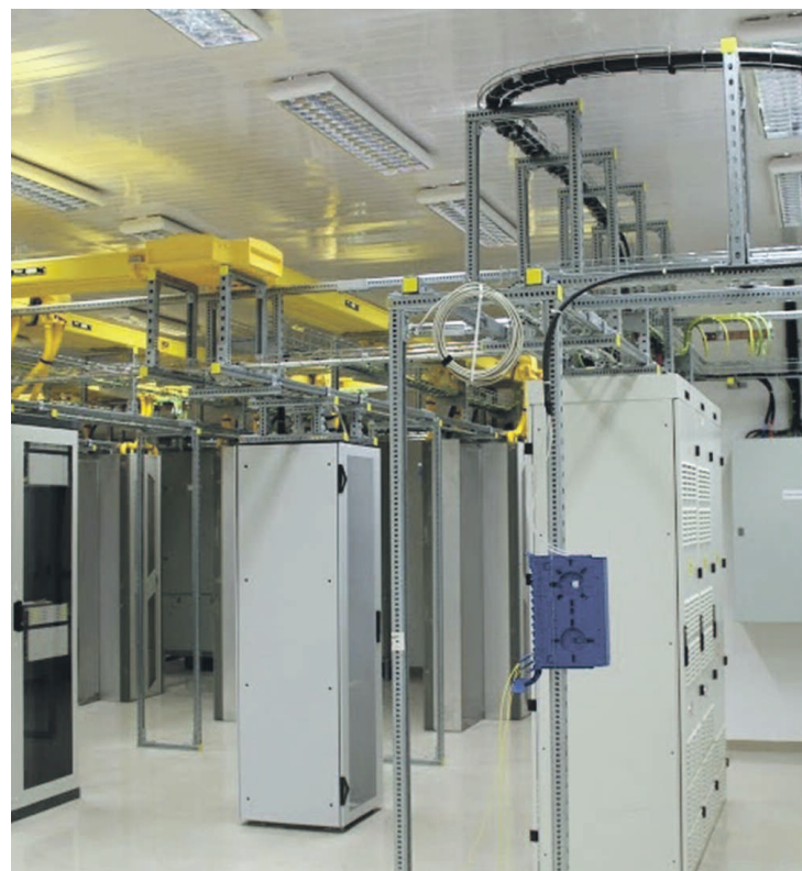
Vue intérieure de la station d'atterrage de Muanda
