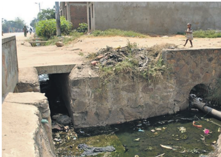
Un caniveau complètement bouché
