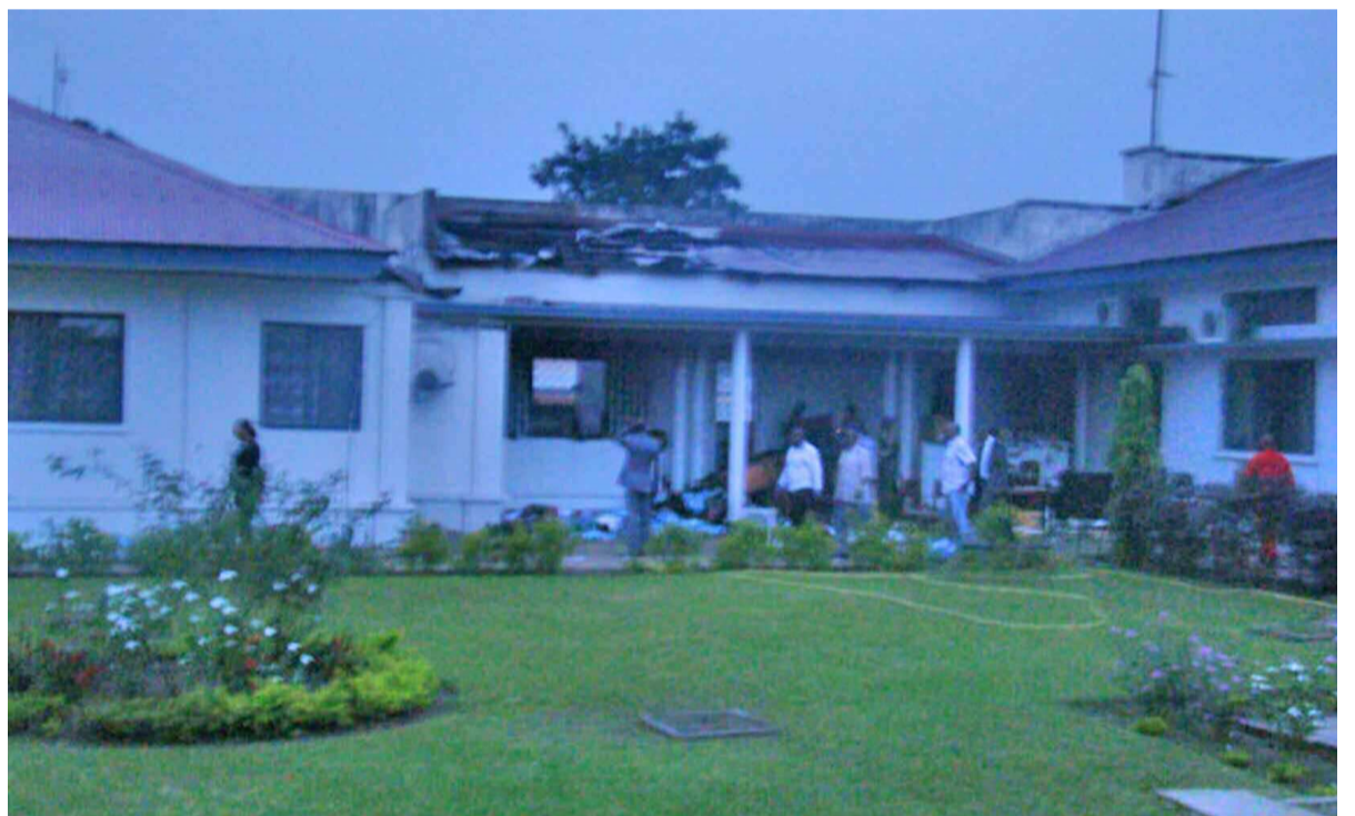
Le bureau qui a pris feu visible par le trou au dessus du toit
