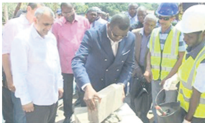
Josué Rodrigue Nguonimba posant la première pierre (© DR). de loisirs. Les travaux entièrement financés par la société libanaise s'exécuteront pendant quatre ans.
