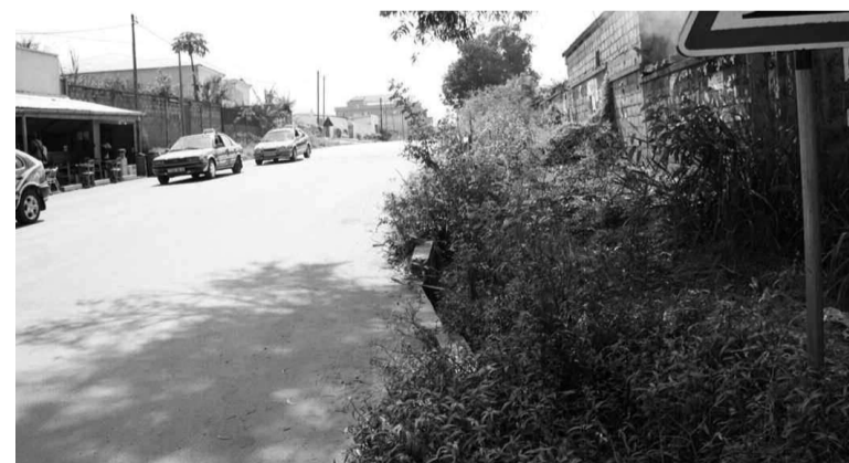
Un caniveau obstrué en centre-ville à Pointe-Noire (© Adiac)
