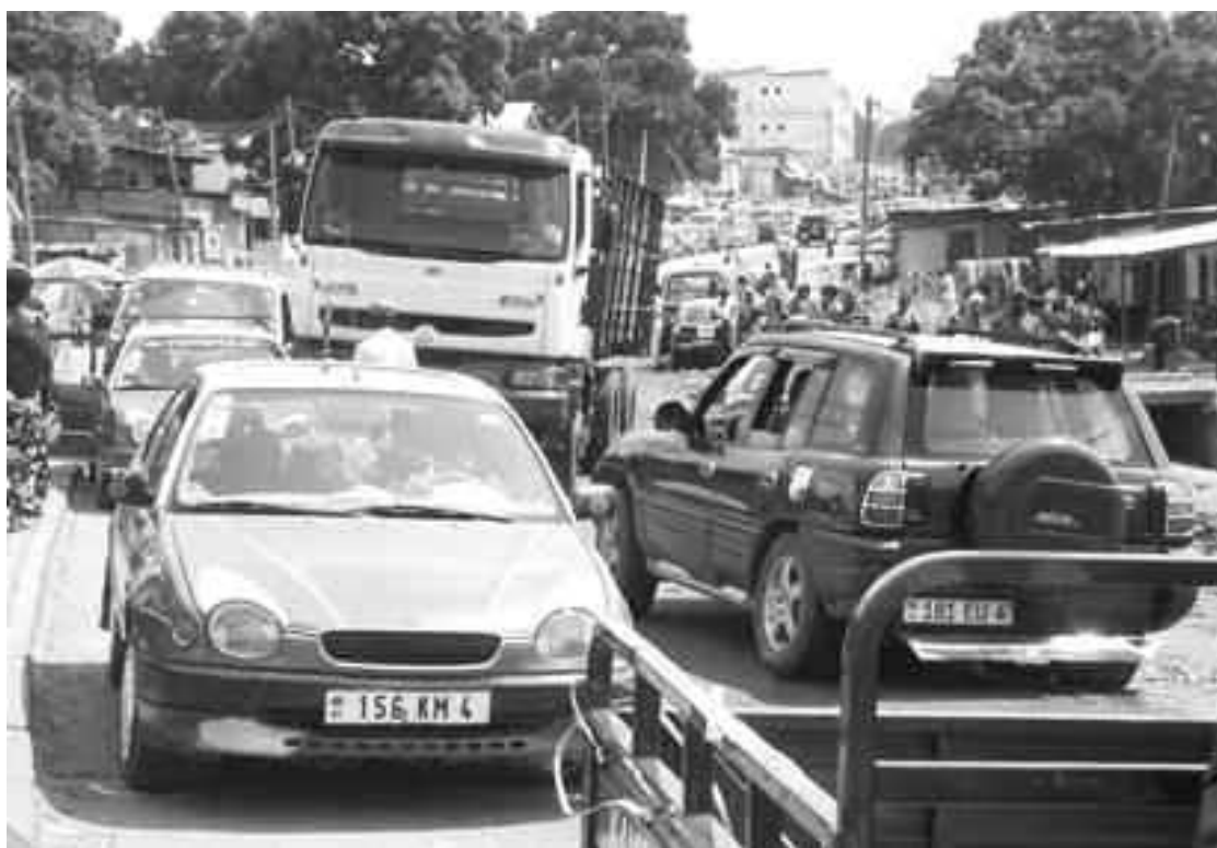
Brazzaville : la détérioration du pont de Mikalou, dans le 6 e arrondissement Talangai, ajoute aux embouteillages
