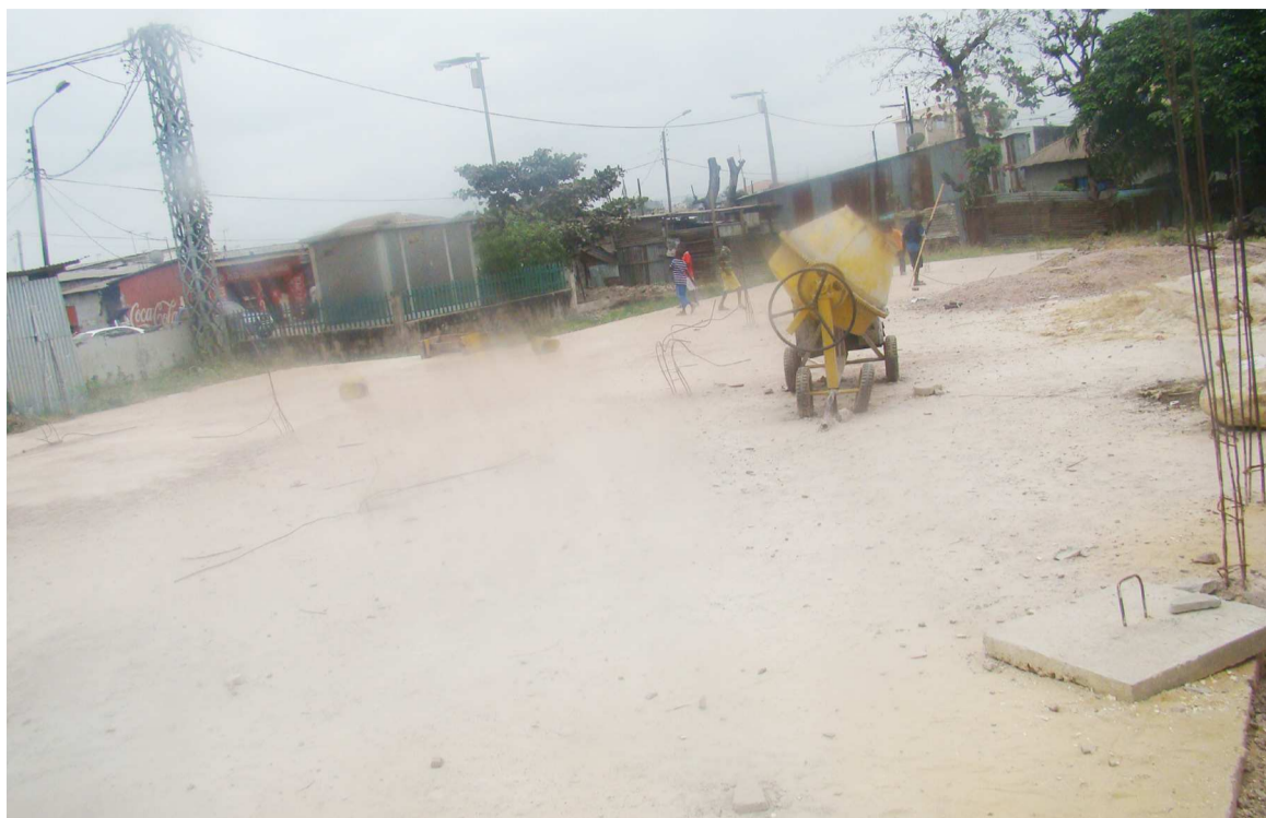
Les travaux du nouveau bâtiment abandonnés par l'entreprise; crédit photo Adiac
