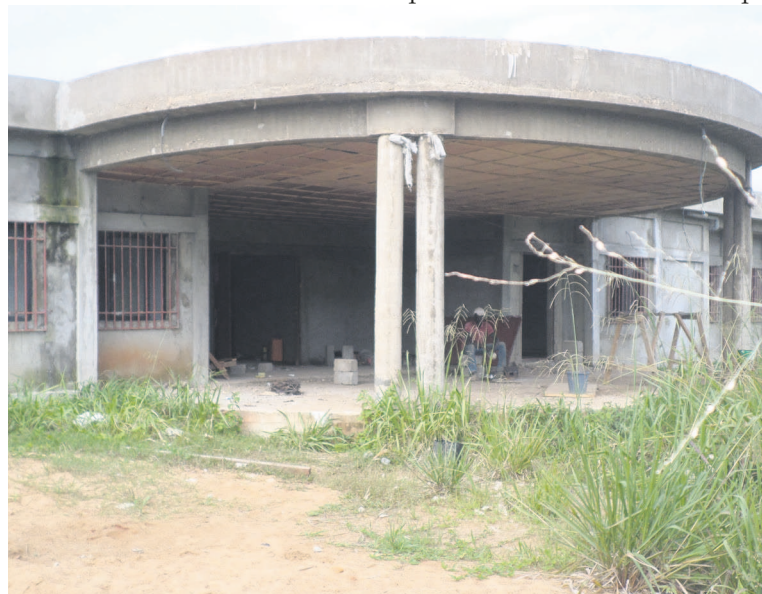
Le chantier abandonné du Centre intégré de santé de Pokola
