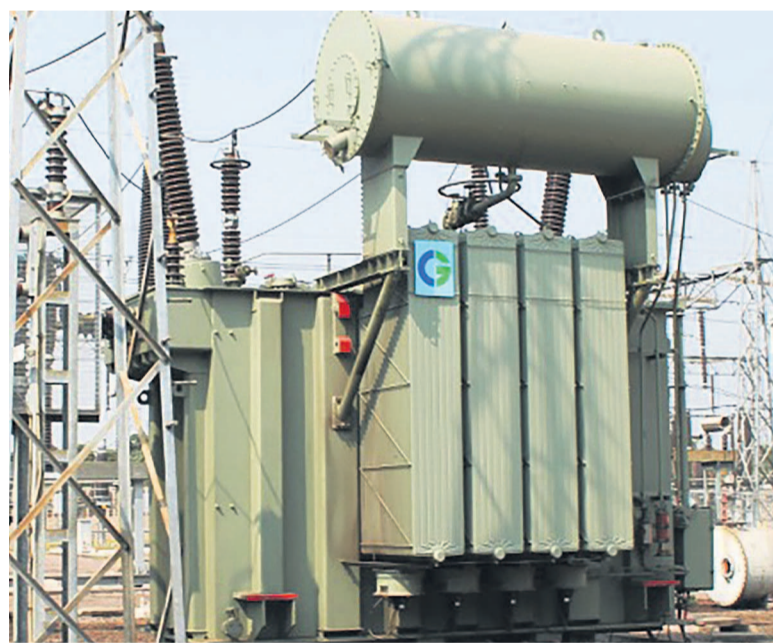
Un transformateur de la Snél au poste de distribution
