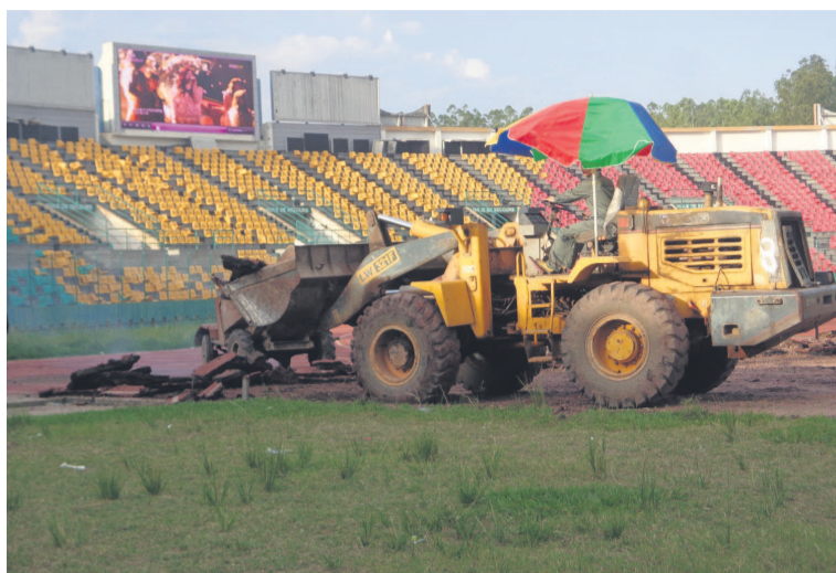
Un engin de la société Zhengwei entrain de decaper le tartin de la piste d'athlétisme (Photo Adiac)
