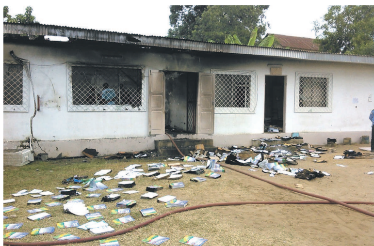
Ouvrages brûlés et jetés à même le sol
