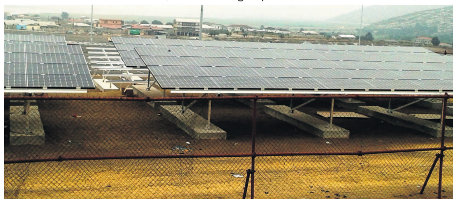
Panneaux solaires voltaïques
