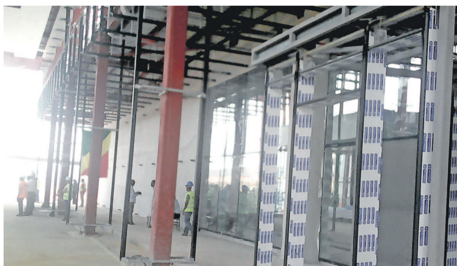
Une vue du chantier du Centre de conférence de Kintélé (photo adiac)
