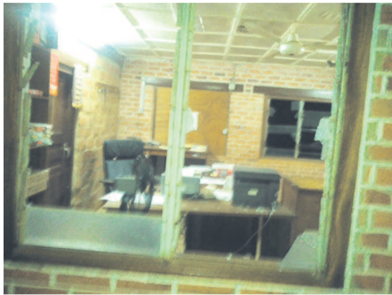
Les bureaux des éco-gardes vandalisés
