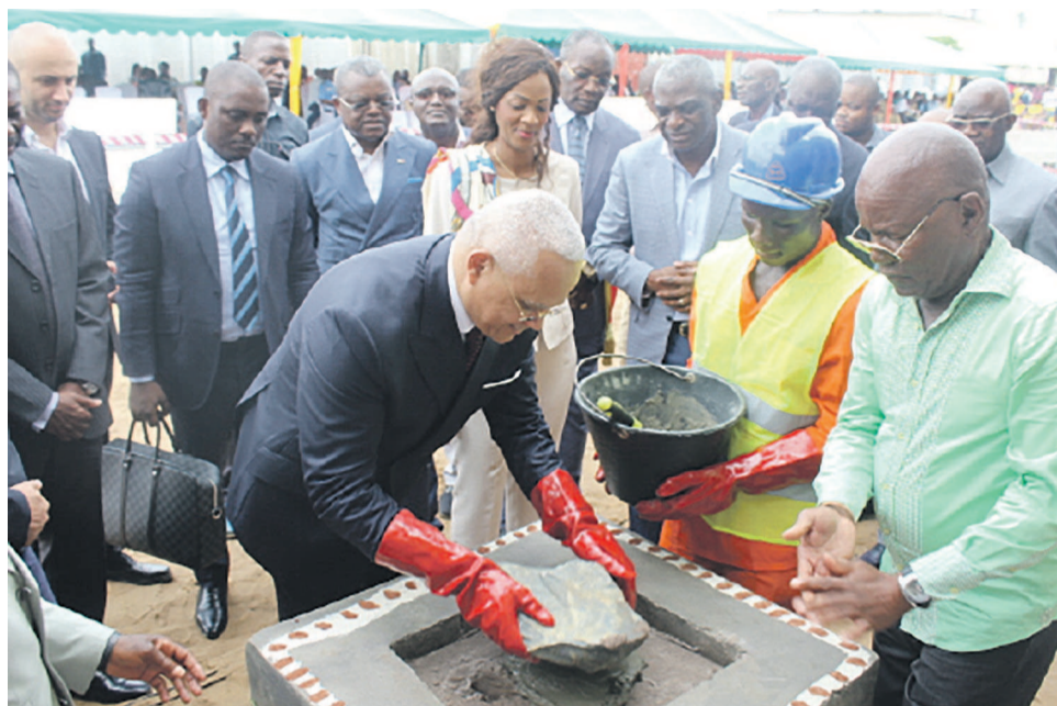
Jean Marc Tchystère posant la première pierre des travaux de réhabilitation du bâtiment du cercle africain / photo Adiac
