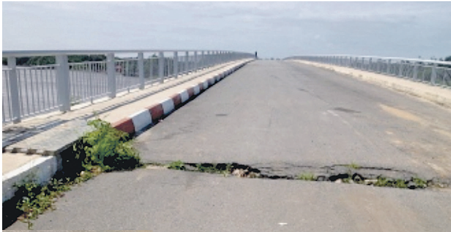
La dégradation du pont sur le Kouilou/ crédit photo Adiac
