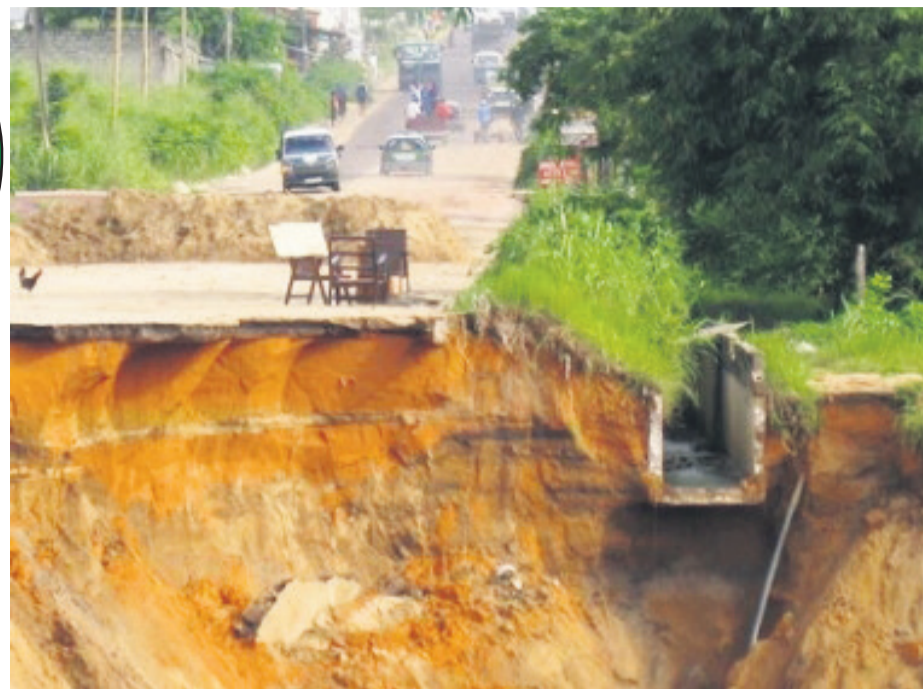
Vue des érosions à Brazzaville (DR)
