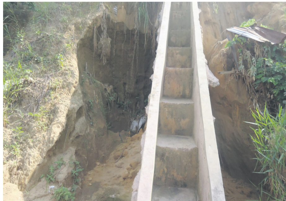
Un ouvrage public menacé par une érosion (DR)
