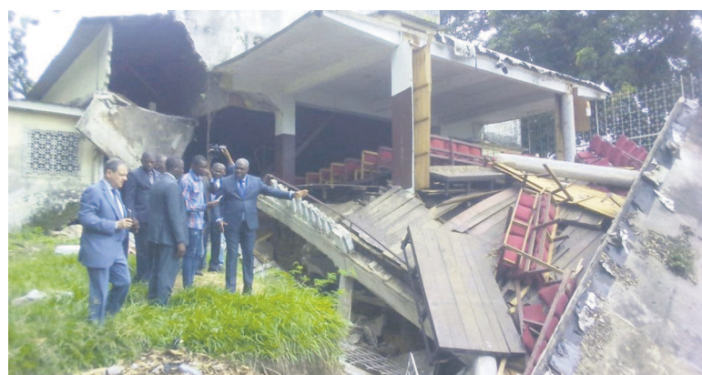
L'arrière bâtiment du Cfrad entièrement effondré
