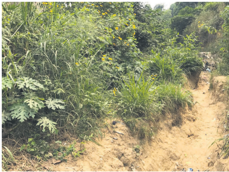
Une rue du quartier 68 menacée par des érosions/DR
