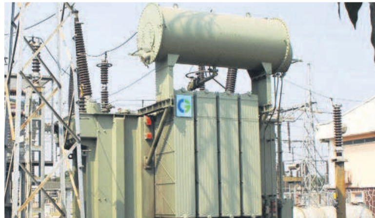
Une cabine électrique de la Snél
