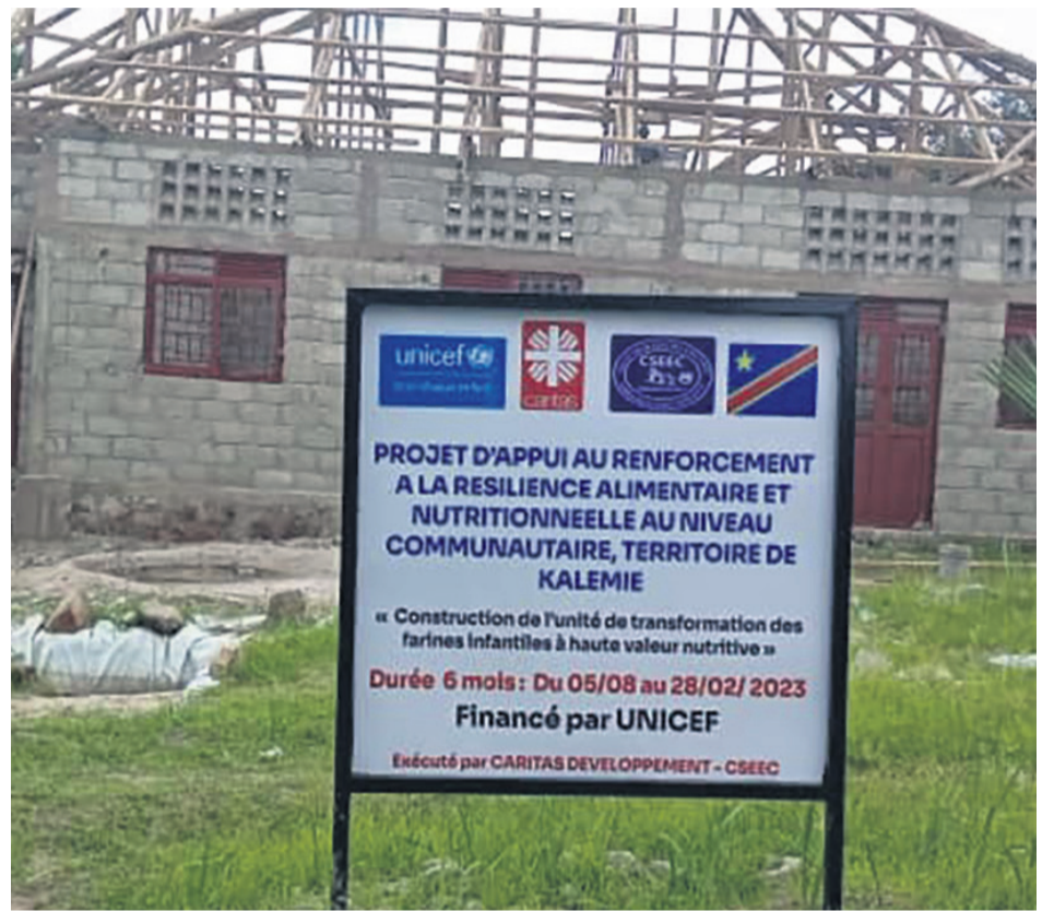
Le chantier de l'unité de transformation des farines à haute valeur nutritiveDR
