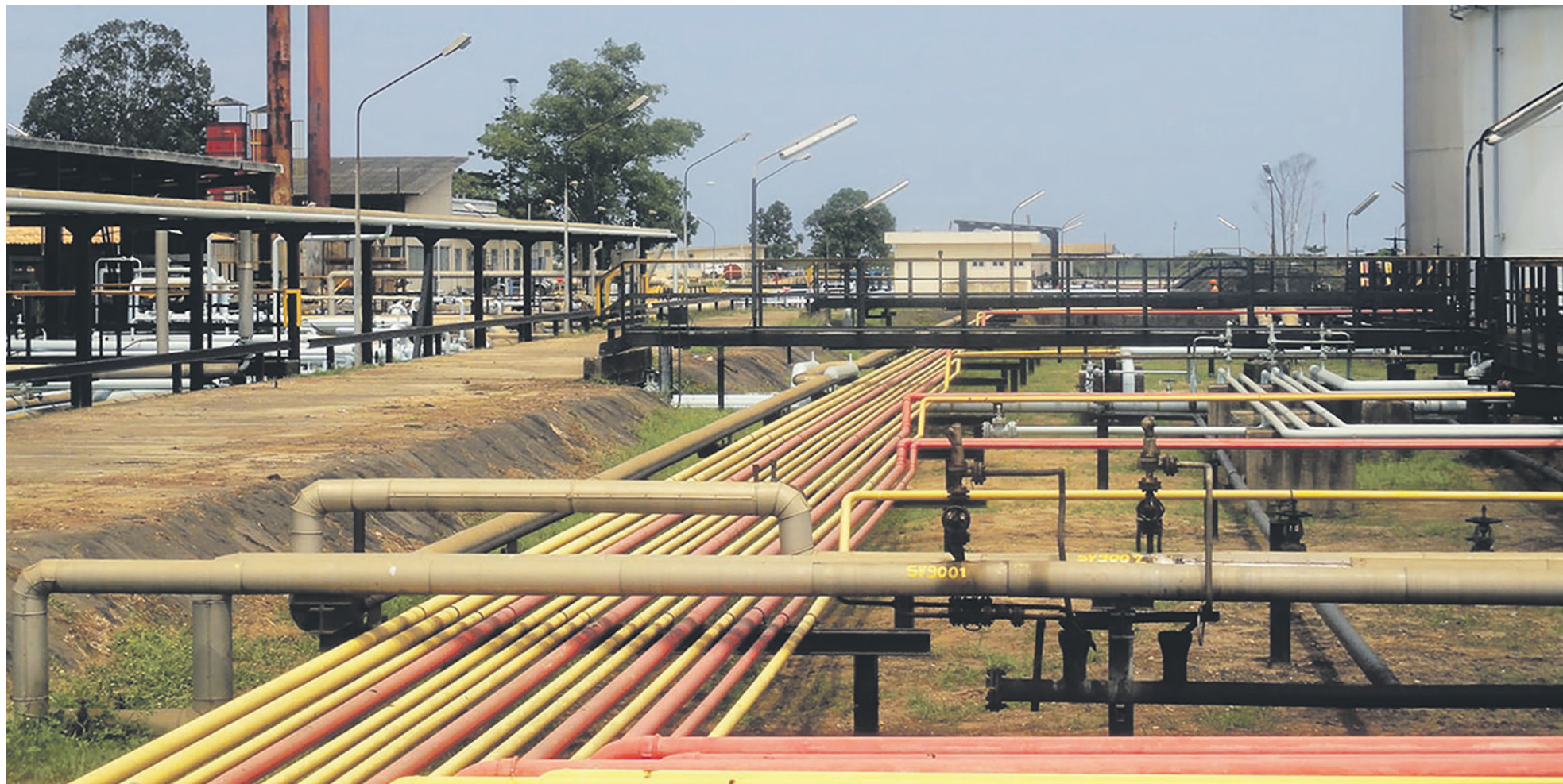
Les installations techniques de la société DR
