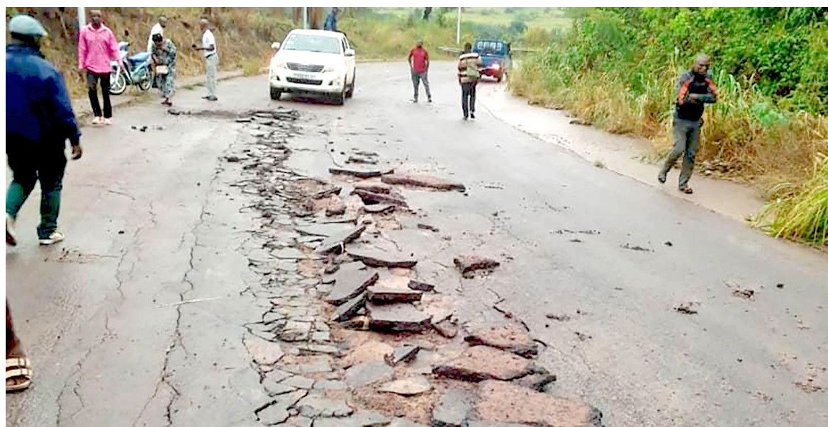
Une partie de la chaussée dégradée. DR
