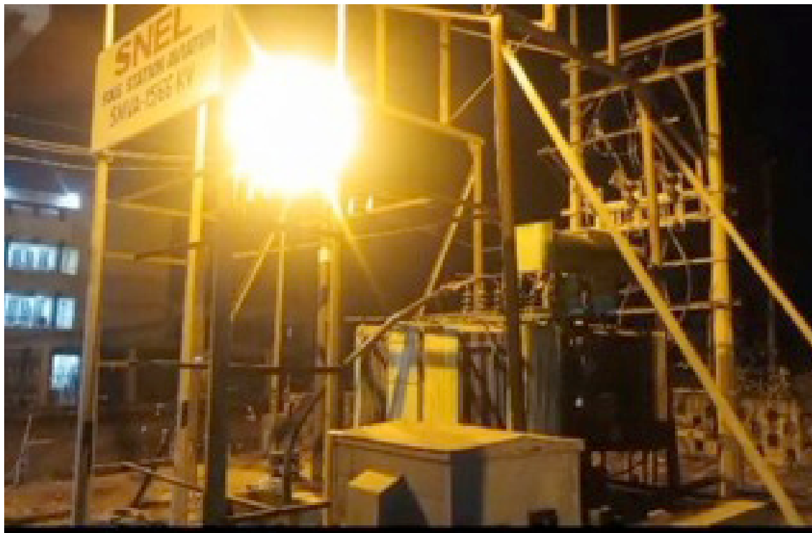
La sous-station Aviation à Bandundu ville remise en service par la Snél
